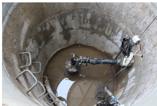
Der er vand i bunden af tørbrønden.
